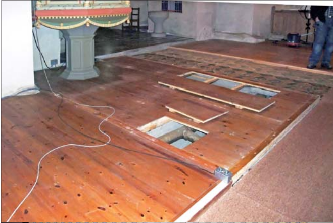
Värmsystemet ligger under kyrkgolvet i gjutna kulvertar. Foto ÖLM 2011.
