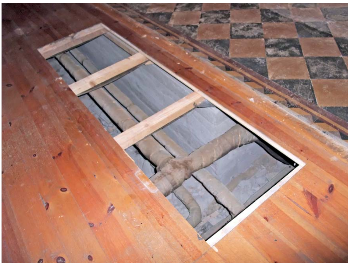
Delar av kulvertsystemet för lågtrycksångan. Fotografet visar rör som ligger under det förhöjda golvet i bänkkvarteren. Foto ÖLM 2011.
