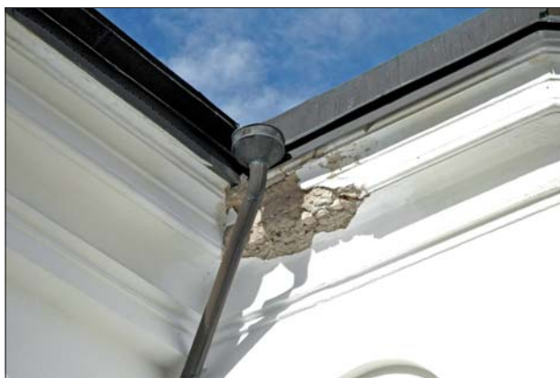
Putsskada i takfoten i anslutning till stupröret.
