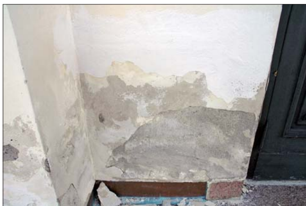
Skada vid västportalen.
