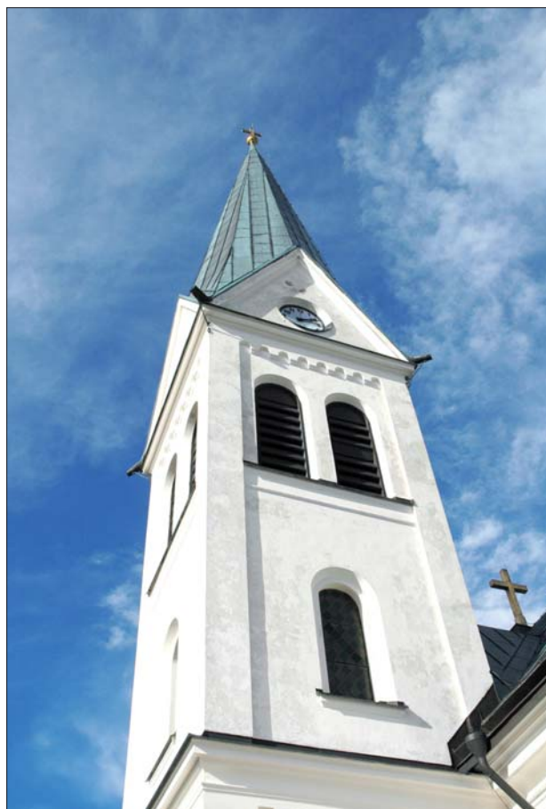
Tornets östra fasad vetter mot Valdemarsviken och uppvisade stora partier med flagnad färg.
