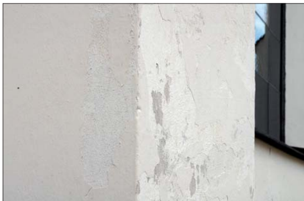
Ett väggparti med flagnande färg.
