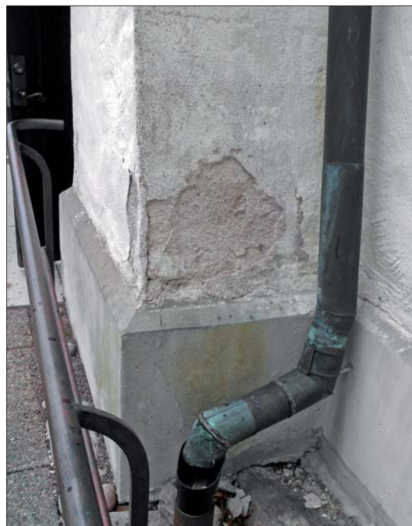
Puttskada vid huvudingången i söder.
