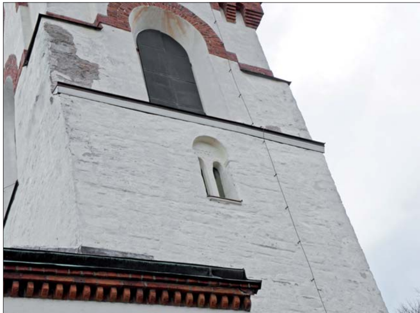
Tornets största puts-skada var i sydvästra hörnet.
