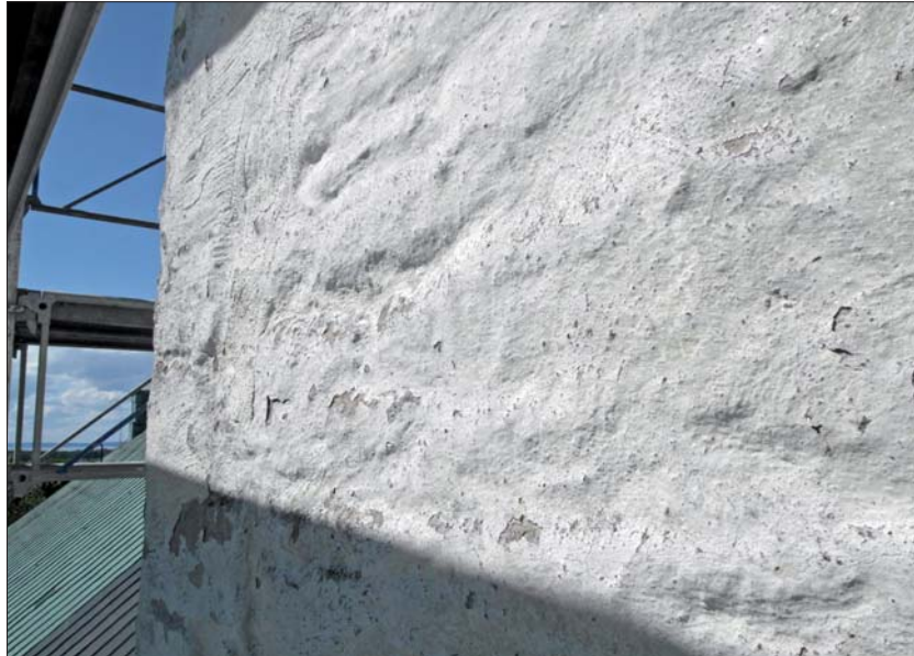
Färg som släpper på tornfasaden.
