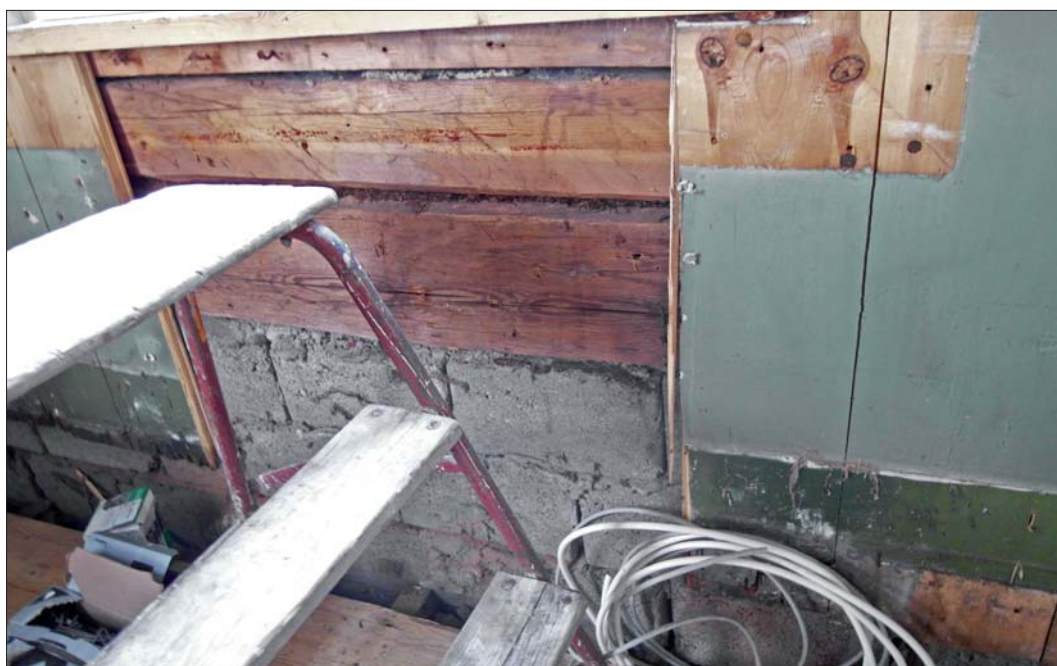
Nedre delen av kyrkans väggar har tidigare lagats med lättbetongblock. Troligen är det dessa block som avses i en tidningsartikel 1945, som omtalar en ny och ventilerad stengrund.
