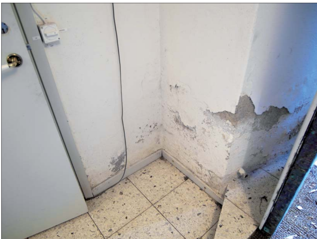
Invändig putsskada i källaren i anslutning till källarentrén i norr.
