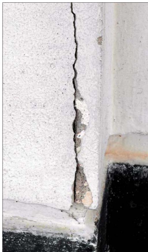
Detaljbild på putsskada.
