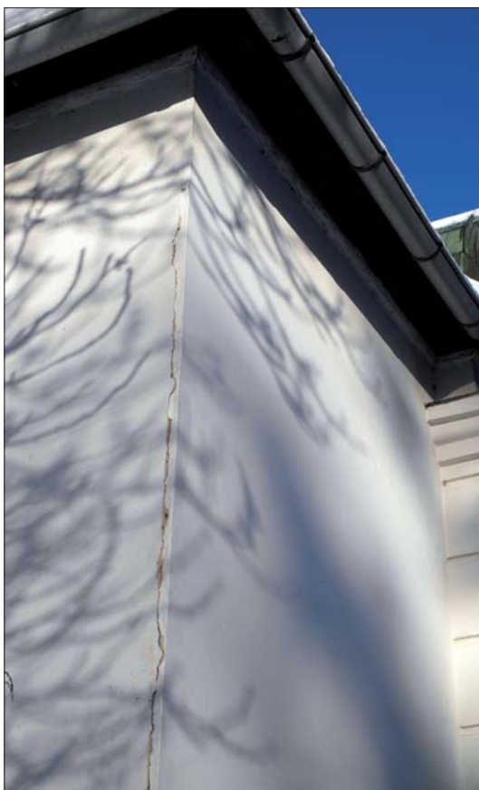
Skadorna i fasadputsens såg delvis ut som om putsen sprack upp som ett skal.
