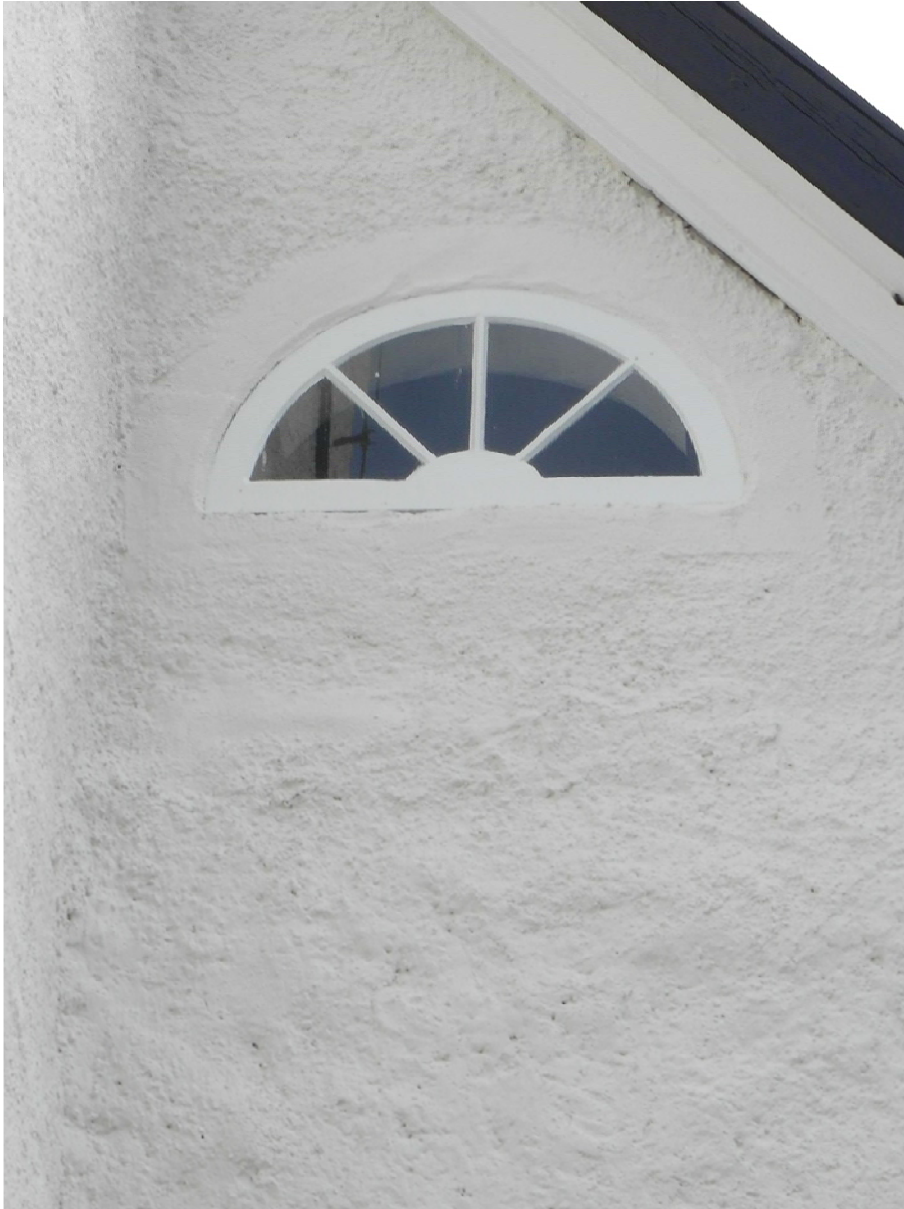
Lunettfönster söder om tornet. Bottenstycke och spröjsar har bytts ut. Springan runt fönstret har fyllts ut med murbruk. Av fotografiet framgår det även att befintlig puts på sina ställen sitter i tjocka påslag.
