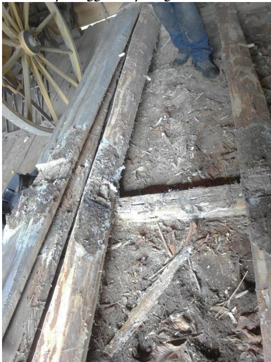
Stockar med hussvampsangrepp.
