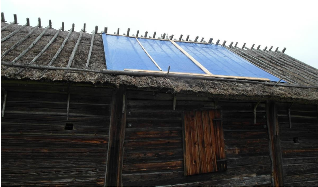
Täckning av skada på halmtaket på loge B 23 med presenning på västra takfället.
