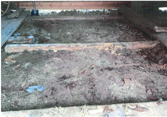
Lös jord mellan bjälkar.
