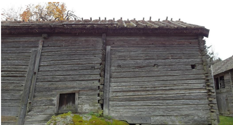
Slall/lövlada med skadad träkonstruktion för stråtak.
