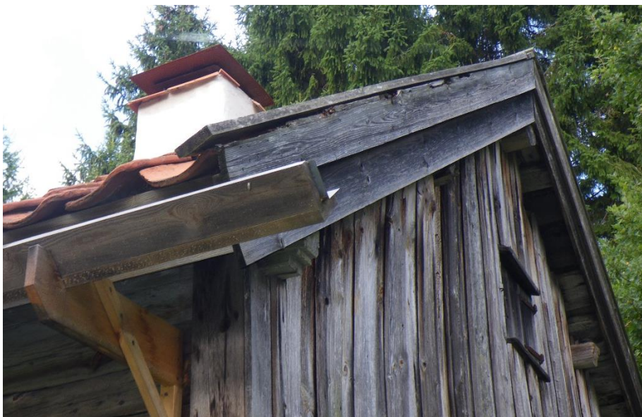
Hagalund, rötskadad vindskiva och skurlist.
