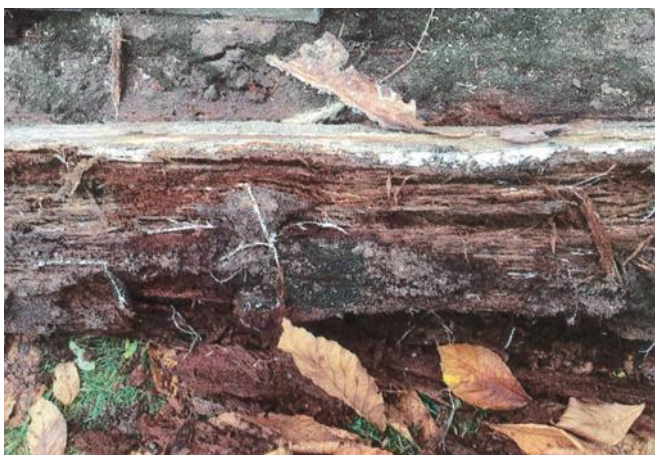
Hussvampsangrepp på en bjälke.
