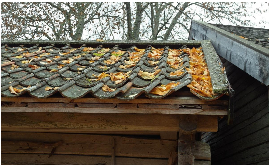
Stolpboden har rötskadade skurlister.
