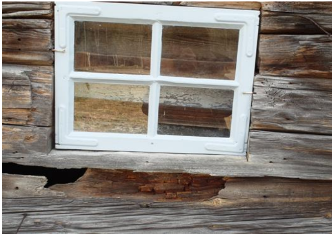
Rötskada under fönstret i ladugård i B delen.
