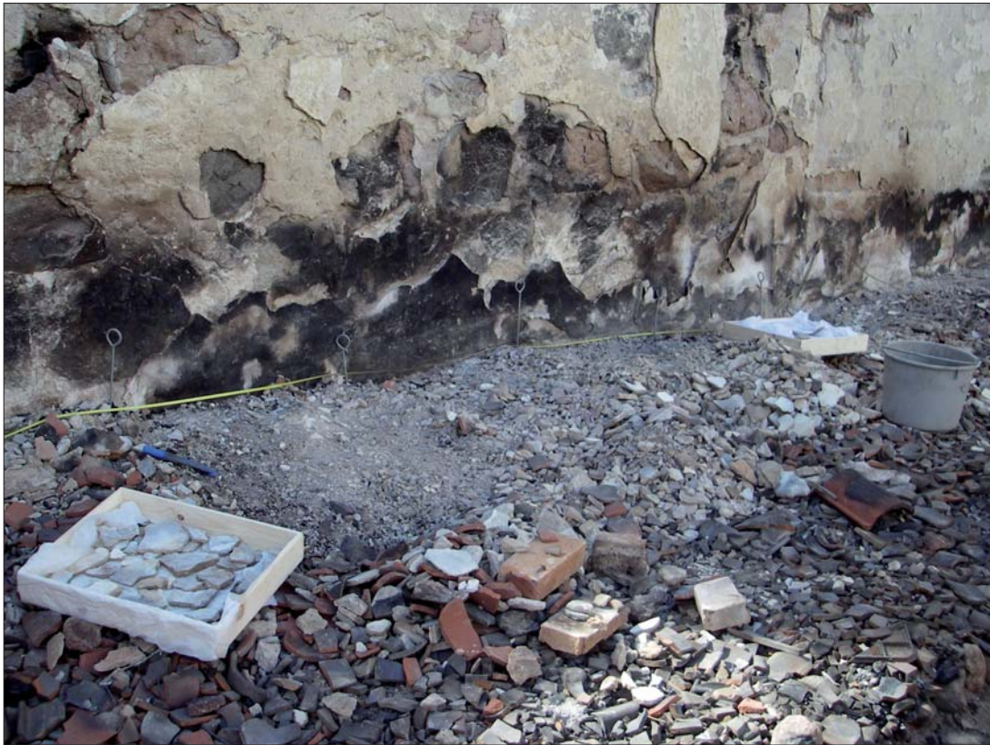
Figur 58. Nerfallna putsfragment med kalkmålerier uppsamlades i lådor märkta med meterangivelse beroende på var bitarna påträffades utefter södra långhusväggen. Foto ÖLM.
