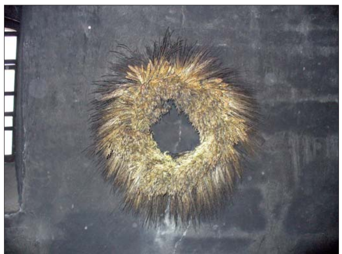
Figur 44. På den västra sotskadade väggen i tornets bottenplan påträffades efter branden en så gott som helt oskadd krans av strå. Foto ÖLM.
