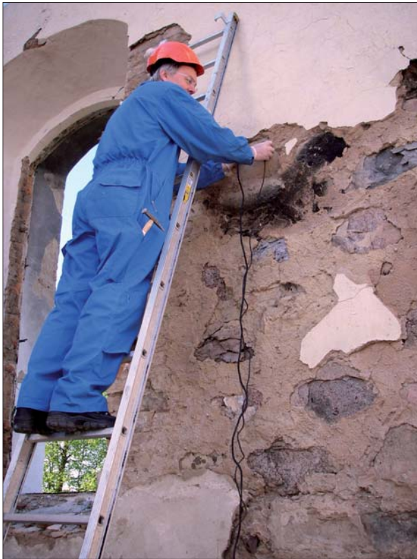
Figur 63. Mätning av murarnas hållfasthet utfördes av Jan-Erik Lindkvist, Sveriges Provnings- och Forskningsinstitut, Borås efter den arkeologiska upp-röjningen. Foto ÖLM.
