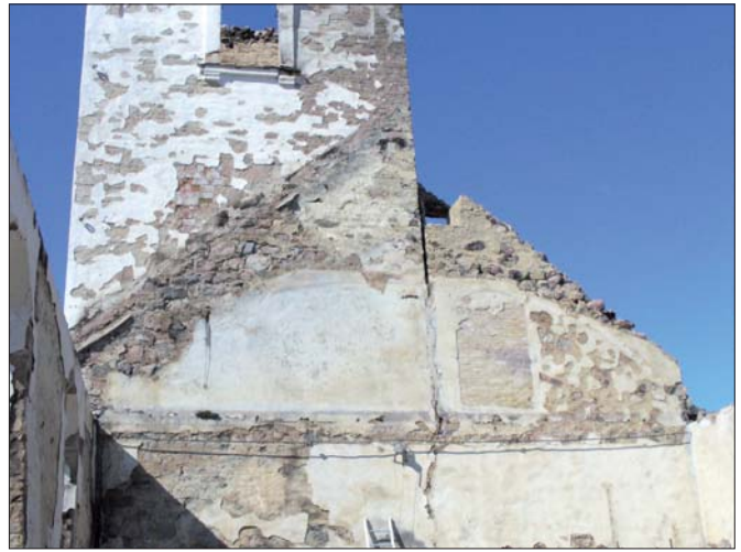
Figur 40. Övre delen av långhusets västvägg och nedre delen av östra tornväggen efter branden. Foto ÖLM.
