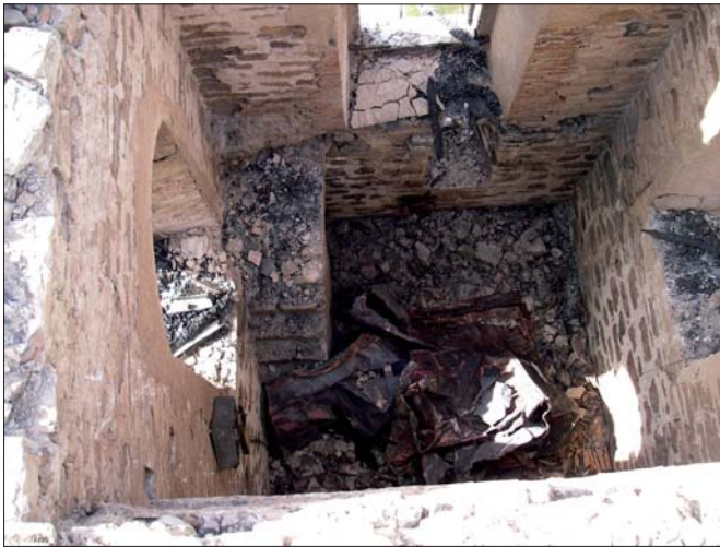
Figur 39. Tornets översta del ovanifrån efter branden. Skyliftfoto ÖLM.
