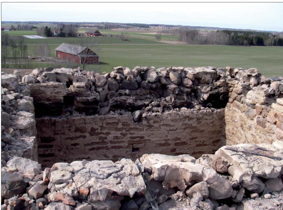
Figur 62. Tornets översta murverk uppvisade kraftiga brandskador både på murbruk och stenar. Efter den arkeologiska uppröjningen säkrades murkrönet och tornet fick ett provisoriskt trätak. Foto ÖLM.
