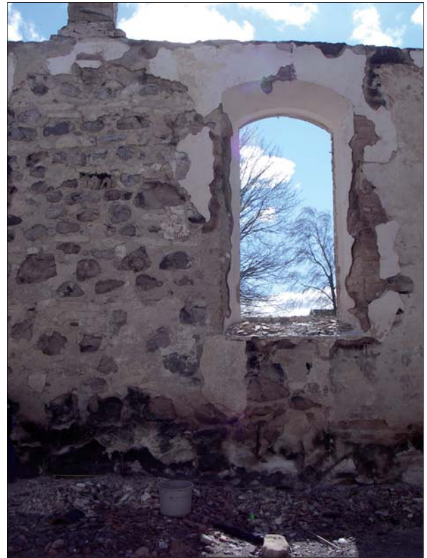
Figur 64. Södra långhusväggen i höjd med andra fönstret efter branden. Under den flagnande putsen mitt under fönstret framträdde hörnstenarna till 1100-talskyrkans långhus. På muren till vänster om fönstret fanns rester av senmedeltida kalkmåleri. Foto ÖLM.
