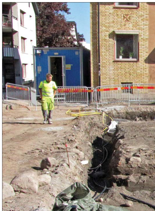
Figur 51. Även mellan den norra och södra ytan öppnades ett smalt schakt. Jämfört med det västra schaktet gjordes här en plandokumentation, främst av konstruktioner. Lagren dokumenterades huvudsakligen med hjälp av en sektionsritning (4762). Foto Emma Karlsson, Östergötlands museum.
