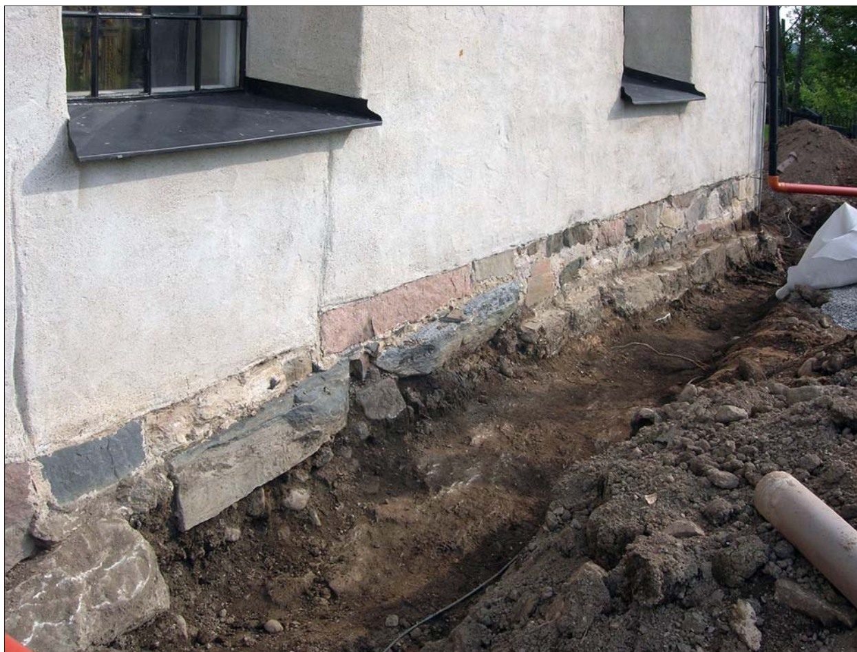
Figur 20. Grundmuren till koret frilagt. I murverket syns tydligt skiljet mellan de två byggnadsfaserna. I den äldsta delen, närmst i bild, består grunden av småsten i kallmur. I den nya delen består av tuktade murar och kalkbruk. Grundmuren vilar här på direkt på berggrunden. Foto från sydväst, Emma Karlsson, ÖLM.
