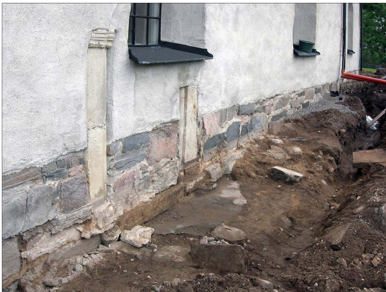
Figur 16. Vid undersökningen frilades rester efter det medeltida vapenhusets murar. Foto från sydväst, Emma Karlsson, ÖLM.
