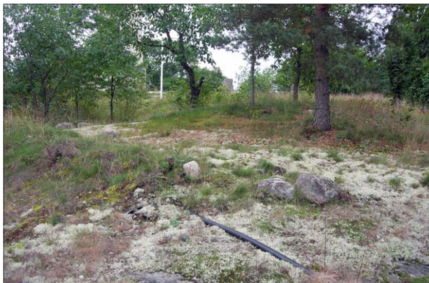
Figur 21. Minst en grav på gravfält RAÄ 25 har skadats då en elkabel lagts genom den. Då kabeln inte kunnat grävas ned just här på grund av berg i dagen har den täckts med jord och stenar. Graven ligger strax bakom församlingsgården. Foto mot öster, Emma Karlsson, ÖLM.
