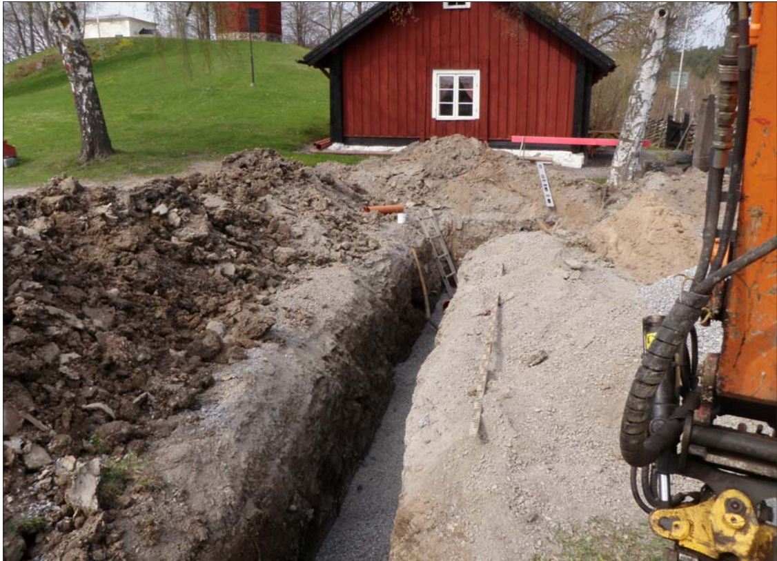
Figur 6. Schakt för VA och el vid Korskullen. I bakgrunden syns själva kullen med väderkvarnen. Vid foten av kullen grindstugan eller knekttorpet från 1700-talet. Mellan stugan och schaktet, bakom björken finns milstenen RAÄ 3.
