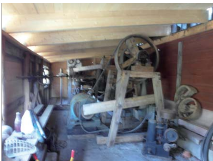
Figur 48. Maskinell utrustning i turbinhuset. Foto Marie Hagsten, ÖM.
