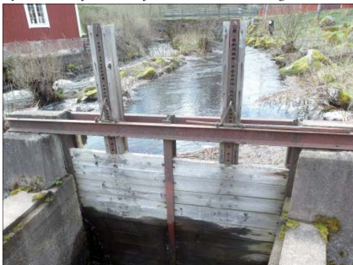
Figur 20. Spettlucka med hål för reglering med spett. Foto från nordnordväst, Marie Hagsten, ÖM.
