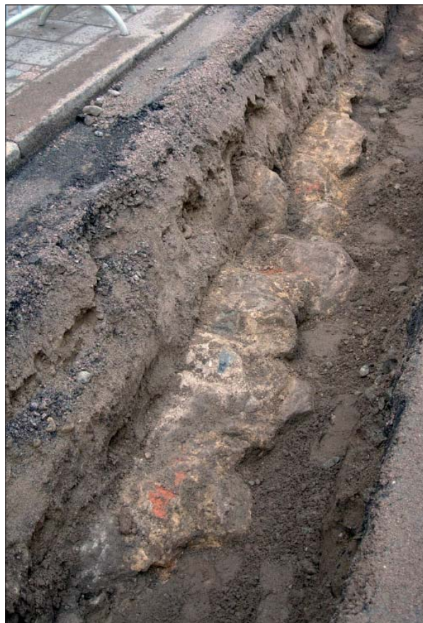
Figur 12. I schaktets södra kant framkom rester efter en murad vägg – del av en källare som påträffades 1957. Mot väster. Foto: Mats Magnusson, ÖM.
