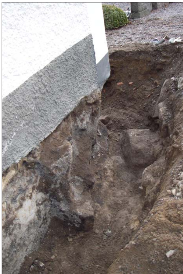
Figur 7. Den medeltida kyrkans nordmur påträffad vid kapellets sydvästra hörn sett från NNV. I kapellets grundmur syns spår efter att kyrkans nordvägg brutits bort. Foto Ann-Charlott Feldt, Östergötlands museum.
