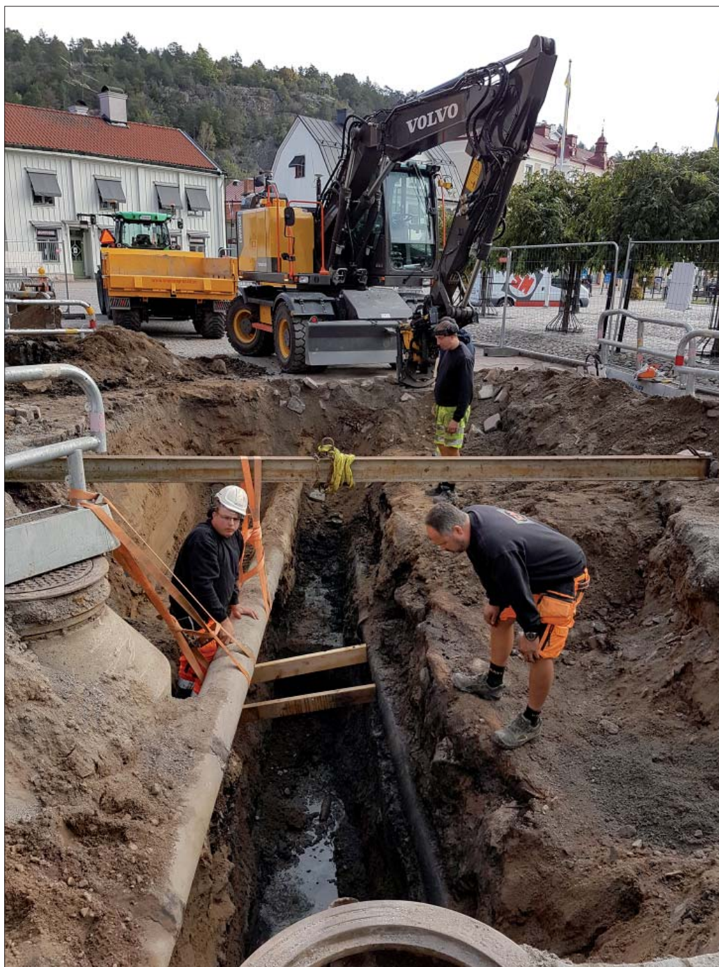
Figur 3. Schaktet öppnades över befintlig avloppsledning vilken gett vika. Foto mot nordost, Emma Karlsson, ÖM.
