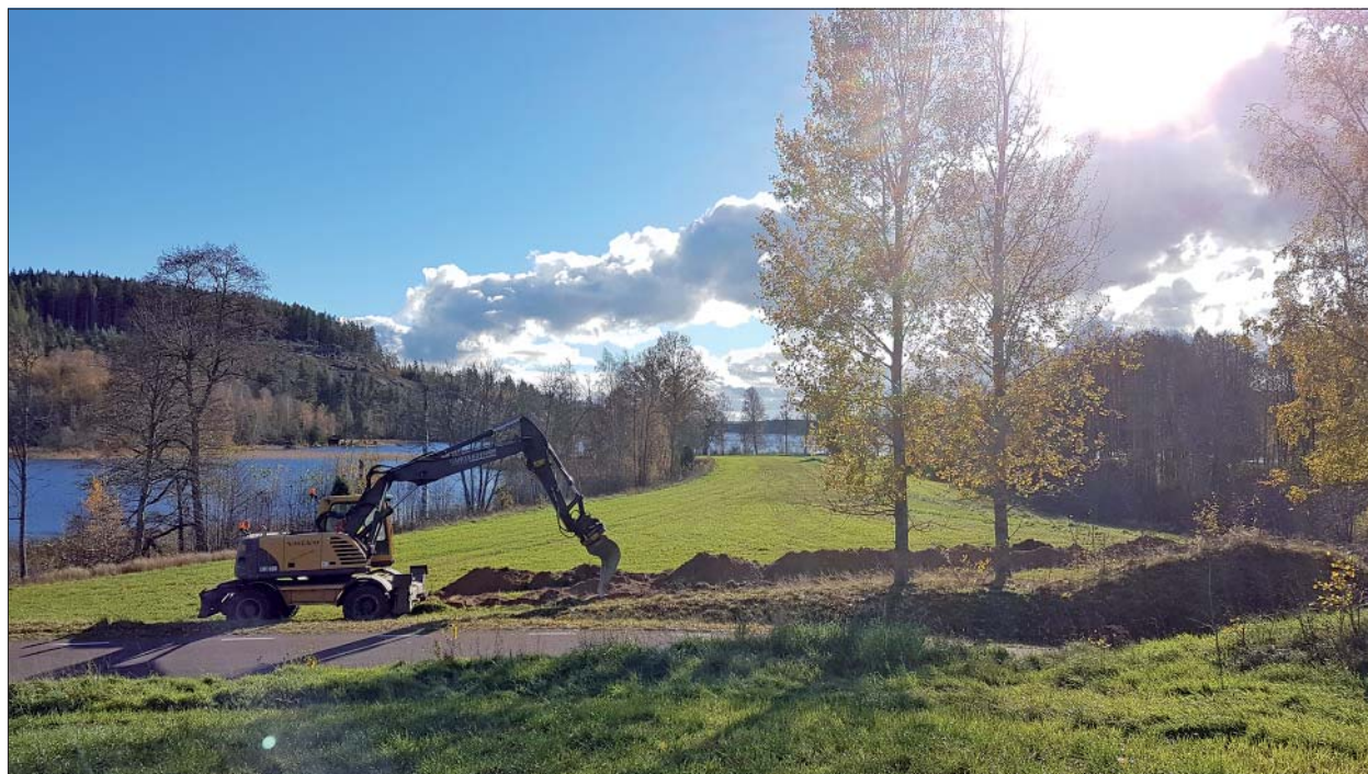
Figur 4. Under pågående schaktningsarbete vid den centrala delen av ledningssträckan, mitt emot gravarna och hälften lokaliserade på andra sidan vägen. Foto från norr, Per Nilsson, ÖM.
