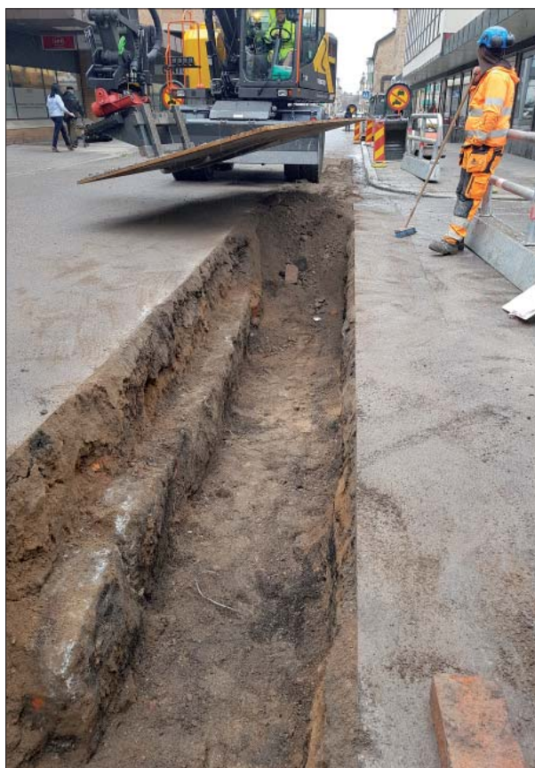
Figur 8. Stengrund i sektion 5b i Snickaregatan. Foto från söder, Helén Romedahl, ÖM.
