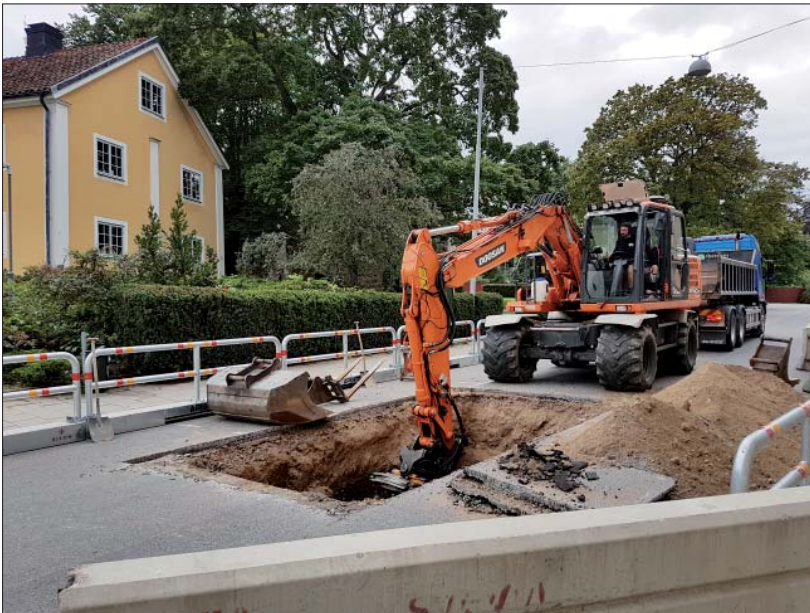
Figur 5. Schaktet sett från nordöst med Rhyzeliusgården i bakgrunden. Foto Ann-Charlott Feldt, ÖM.
