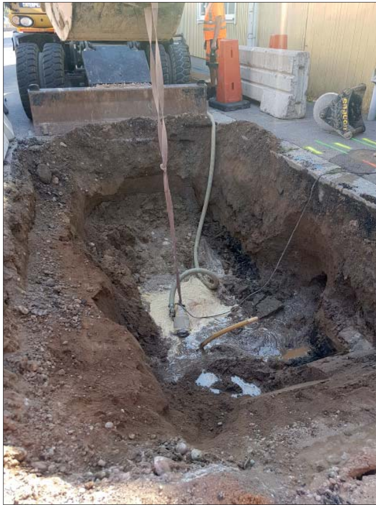
Figur 9. Schakt 3 grävdes för att laga en läcka i en vattenledning. Mörkare kulturlager syns ovanför vattnet på 0,9 m djup. Foto Ann-Charlott Feldt, ÖM.
