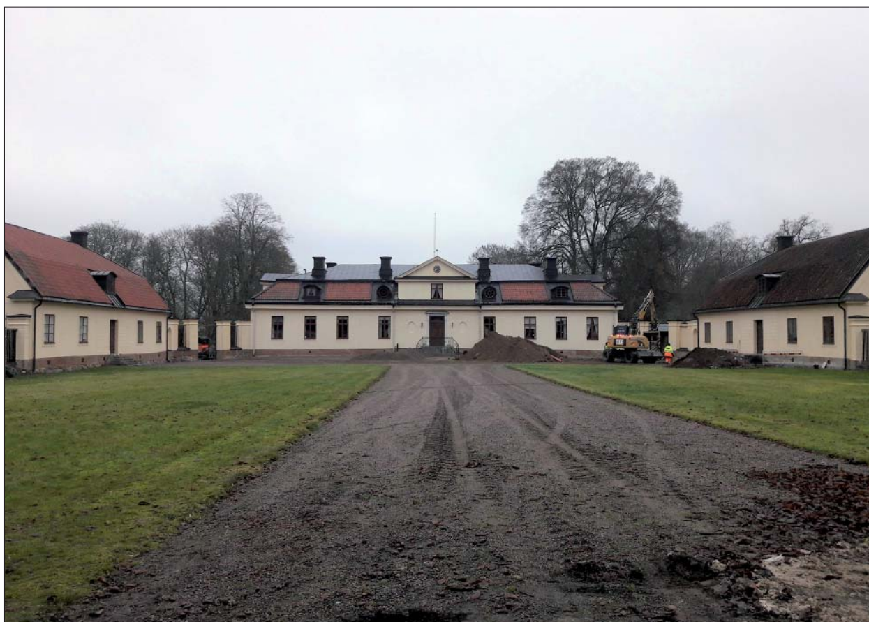
Figur 3. Huvudbyggnaden och den norra respektive södra flygeln på var sida, byggd på 1760-talet. Pågående schaktning i gårdsplanen, invid huvudbyggnaden och den södra flygeln. Foto mot Ö, Linnéa Hernqvist, ÖM.
