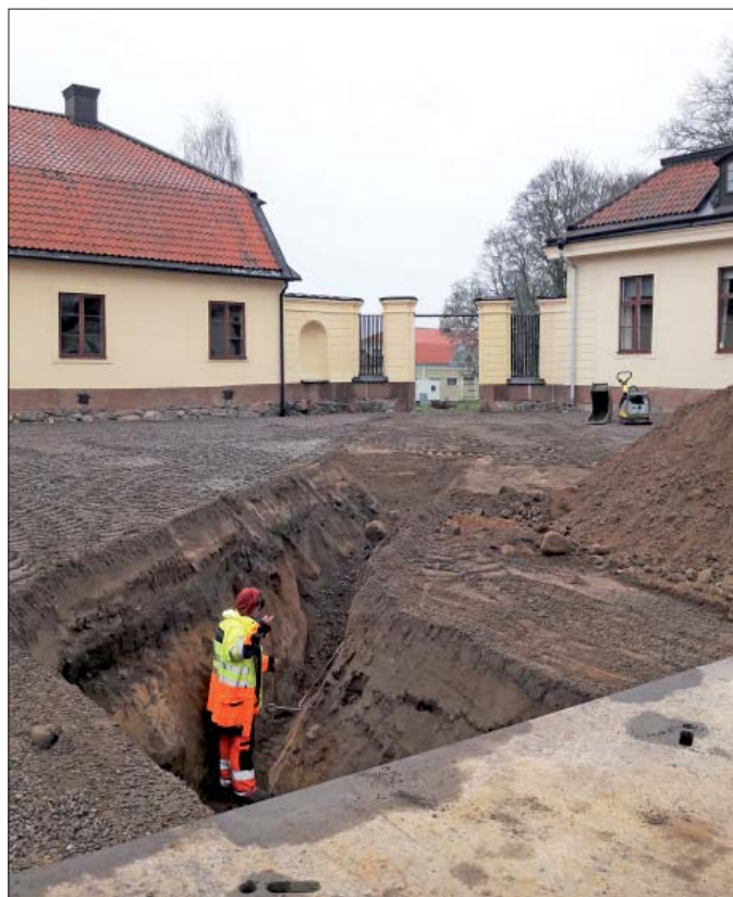
Figur 9. Helen Romedabl dokumenterar östra schaktväggen i gårdsplanen. Foto mot NO, Linnéa Hernquist, ÖM.
