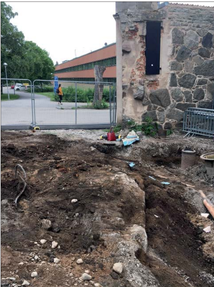
Figur 12. Rester av ett murparti från Länsfängelset. Foto från väster, Helén Romedahl, ÖM.
