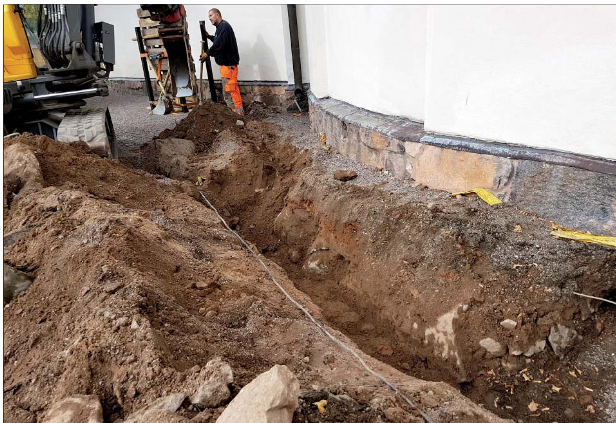
Figur 18. I vinkeln mellan torn och långhus fanns en anhopning av större stenar. Bakom grävmaskinens skopa skymtar den skyddsinklädda gravstenen från 1600-talet. Foto mot nordväst, Ann-Charlott Feldt, ÖM.
