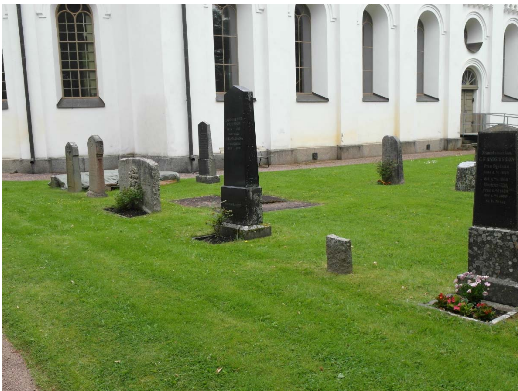
På norra fasaden fanns en del missfärgningar förutom putsbortfall. Foto Östergötlands museum 2014.
