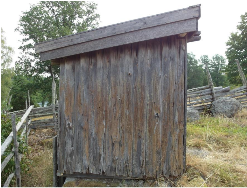
Grå dasset före åtgärder: Västra fasaden är mycket rötskadad.
