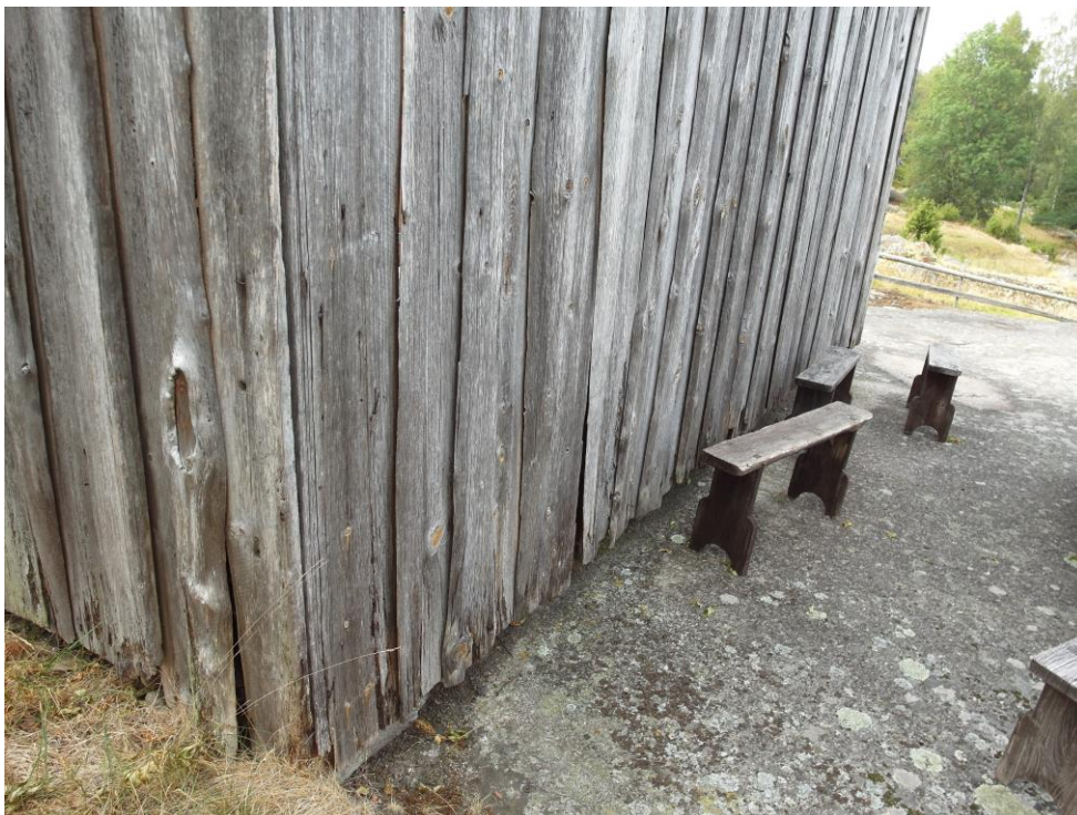
Grå ladugården före åtgärder: Detalj på anfränt panel.
