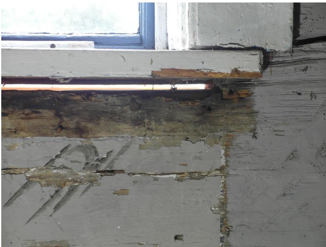
Grå stugan före åtgärder: Rötskador skadar även det invändiga väggmåleriet.
