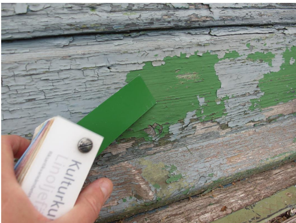
Röda boden före åtgärder: Kromoxidgrönt framkom tydligt på ytterdörr på Röda stugan.
