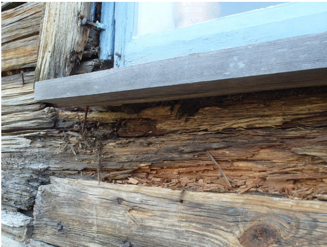
Grå stugan före åtgärder: Rötskador var mer än förmodat.
