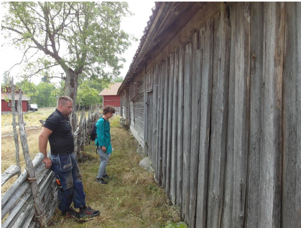
Grå ladugården före åtgärder: Norra fasadens panelbrädor är murkna mot mark.
