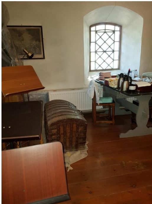
Ny väggradiator i sakristian.
