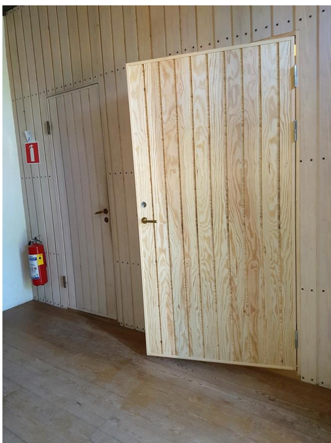
Den nya dörren till elcentralen har ännu inte målats.
