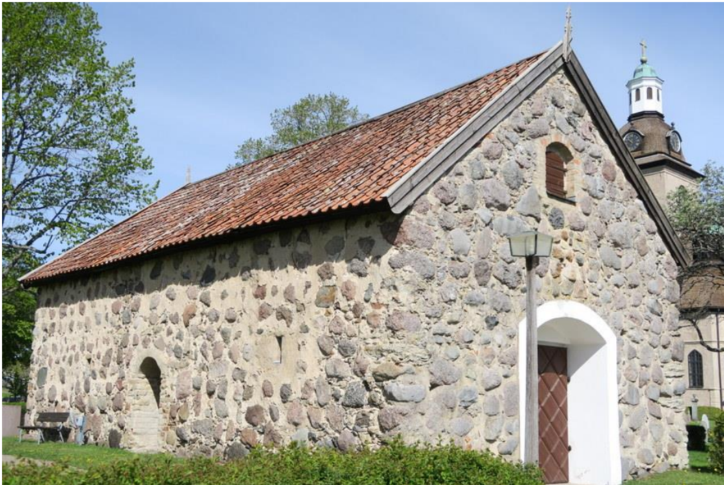
Bisättningshuset från sydöst före takomläggning.
