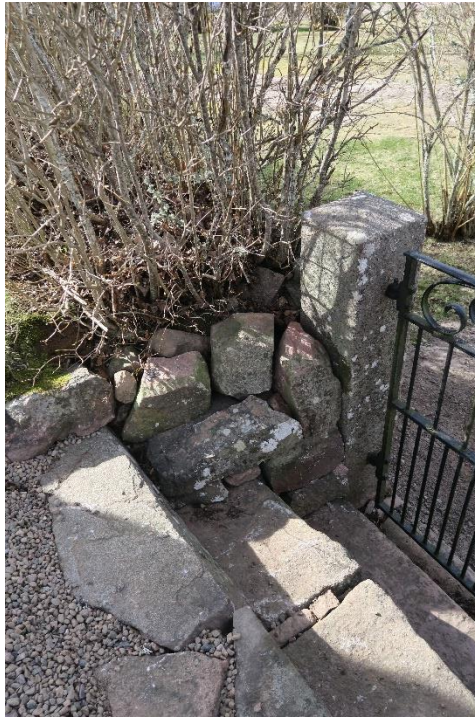
Stenläggning vid grindstolpe efter renovering kan anses något otillfredsställande.
