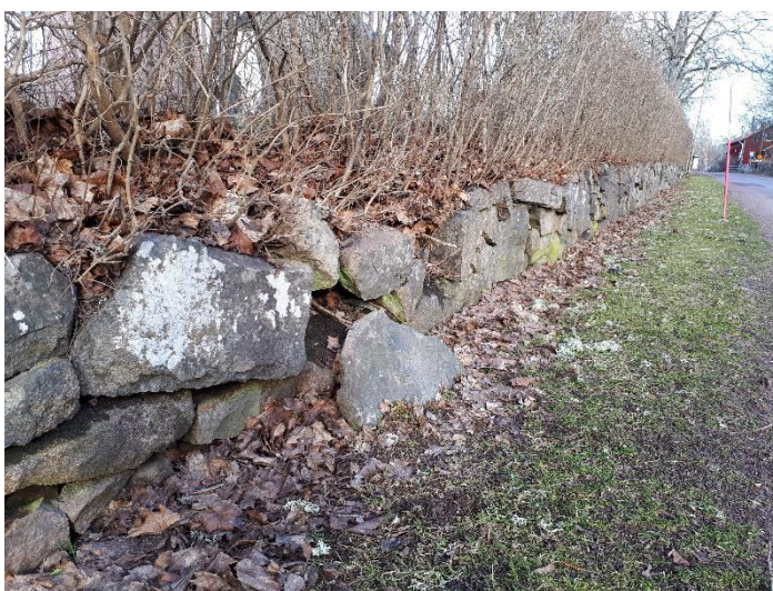
Östra muren, mot norr. Sten har hamnat ur läge och låg instabilt. Karin M.
