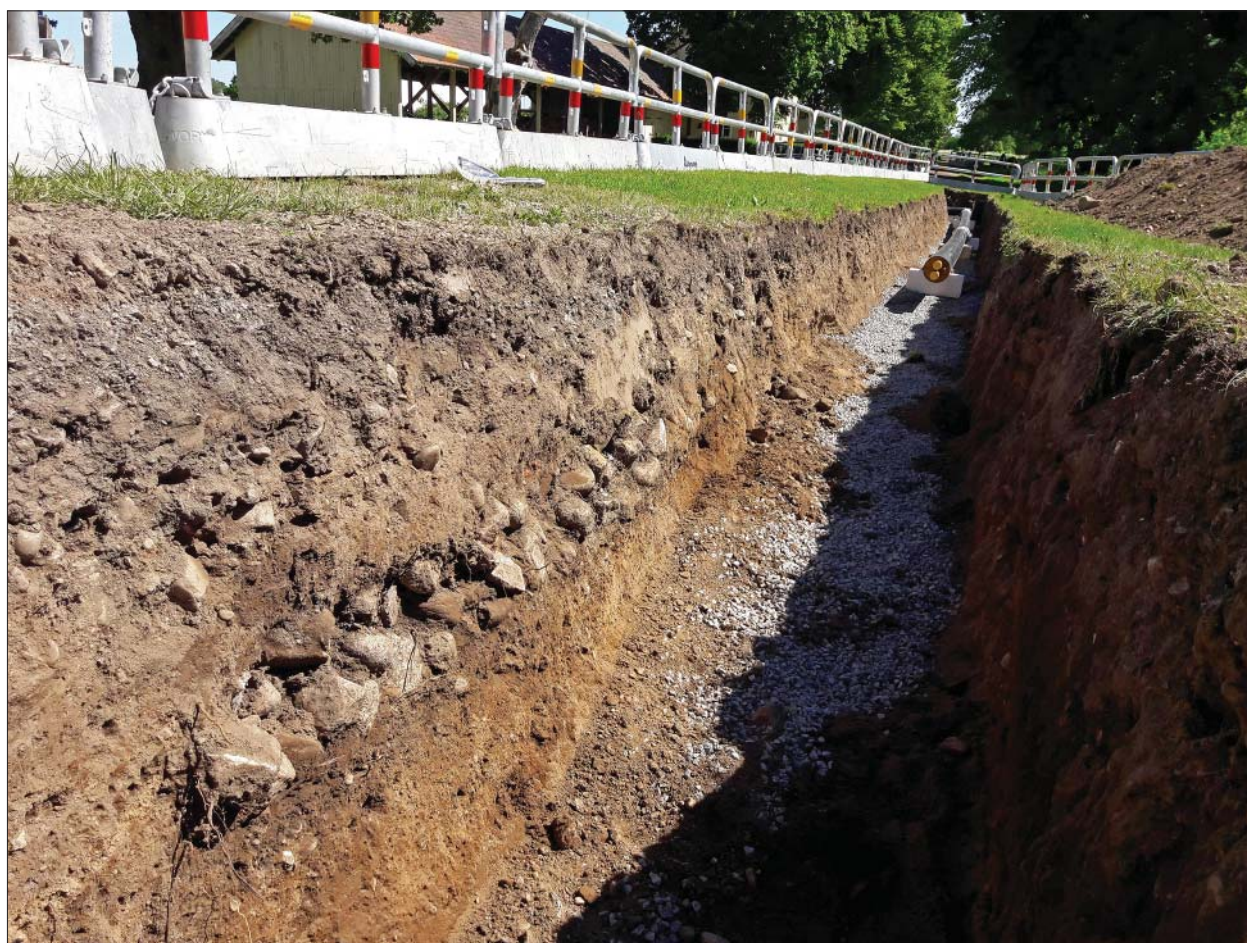
Figur 13. Markförstärkning med sten i västra änden av Del 5. Foto mot Ö, Linnéa Hernqvist, ÖM.
