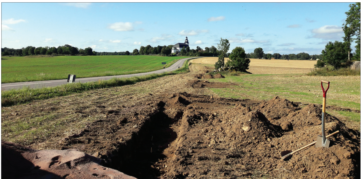
Figur 11 (nedan). Schakt S242 i förgrunden och Stora Åby kyrka i bakgrunden. Boplatslämningar hittades på delar av sträckan och tolkas tillhöra boplatsen belägen på andra sidan vägen som registrerades 2011 (L2008:7559). På impedimenten i åkern är skålgropslokaler. Foto mot SV, Linnéa Hernqvist, ÖM.
