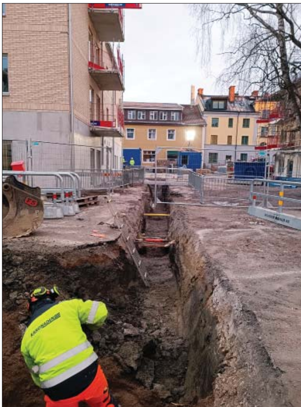
Figur 11. Schaktet var på flera ställen genombrutet av äldre ledningar. Foto från söder, Helén Romedahl, ÖM.
