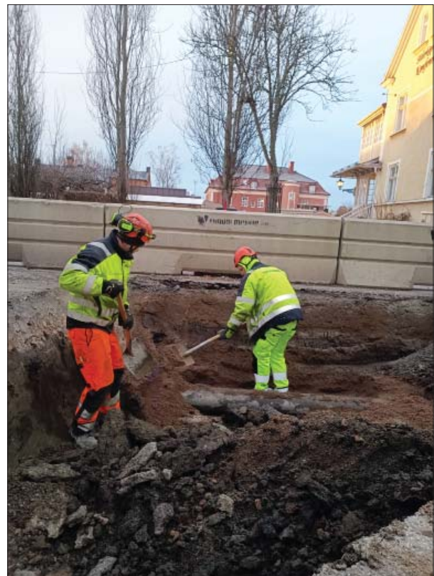
Figur 12. I det bredaste schaktpartiet ute i Bielkegatan framkom en äldre fjärr värmeledning. Foto från norr, Helén Romedahl, ÖM.
