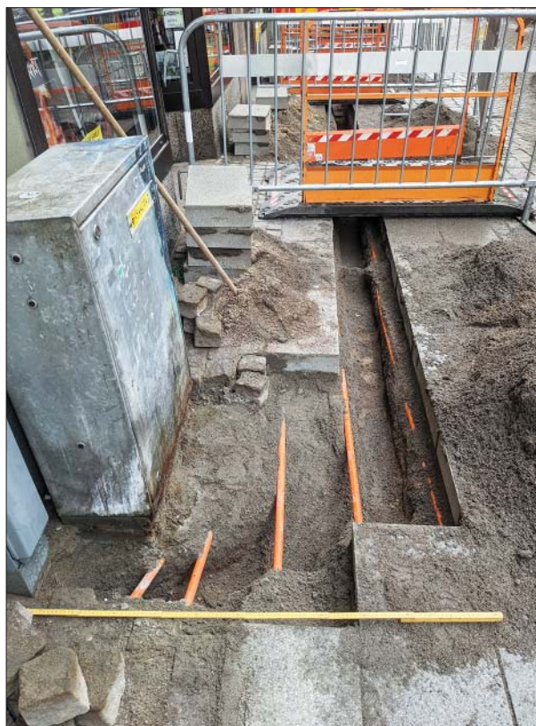
Figur 4. Elskåpet i västra änden av schaktet. Foto mot ÖNÖ. Foto: Linnéa Hernqvist, ÖM.
