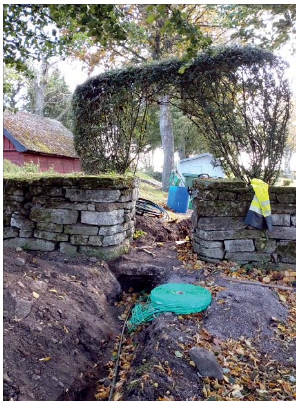
Figur 8. Schaktet tunnades under en stor stenhäll som var placerad som golv i bogårdsmurens öppning. Stenhällen fortsatte in under bogårdsmuren på båda sidor om öppningen. På schaktets östra (vänstra) sida syns en av de större stenar som kan vara en del av bogårdsmurens grundläggning. Foto från nordväst. Foto Ann-Charlott Feldt, Östergötlands museum.
