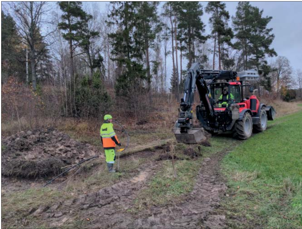
Figur 5. Arbetsbild. Det första schaktet (S1048) påbörjas. Foto mot N, Roger Lundgren, ÖM.
