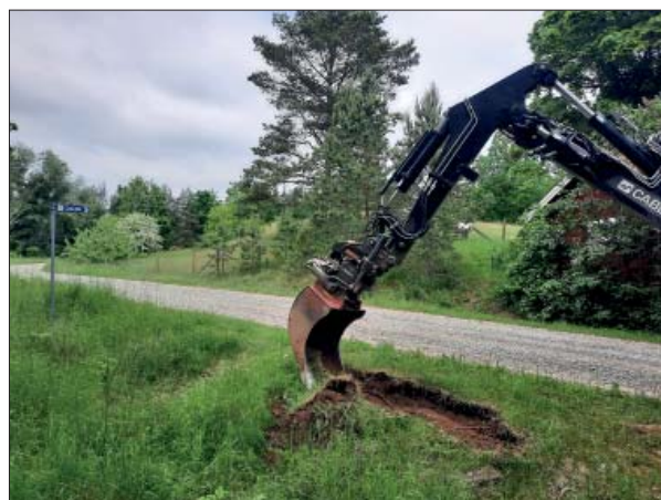
Figur 9. Schaktning vid grusvägen i anslutning till Kapellbackens gravfält. En av gravhögarna skymtar i bakgrunden. Foto mot norr, Per Nilsson.
