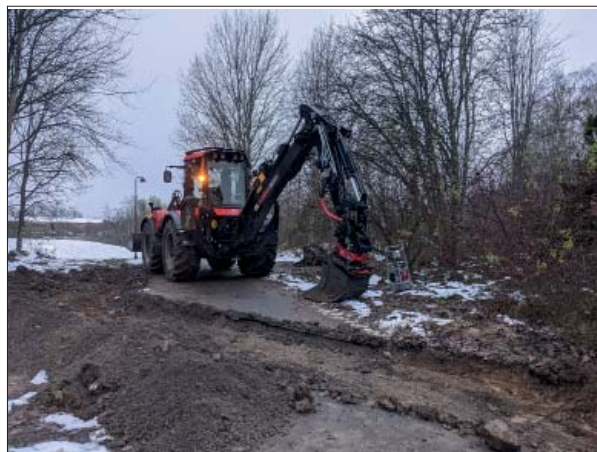
Figur 6. När schaktet återöppnades för kontroll kunde det konstateras att endast återfyllda massor i befintligt elledningsschakt påverkats. I buskaget till höger i bild ligger stensättningen. Foto: Linnéa Hernqvist, ÖM, mot V.
