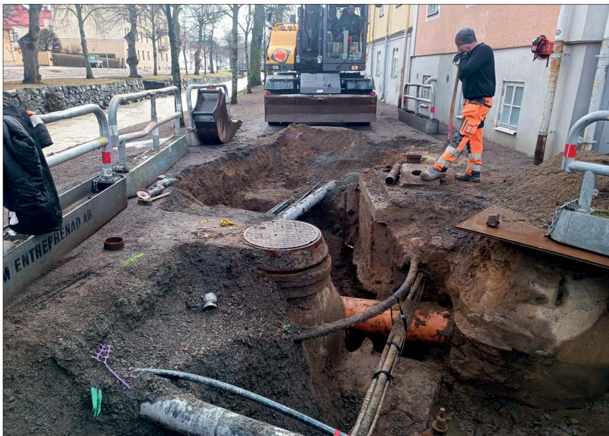
Figur 5. Exempel på ledningsdragningar. Här Östra Hagagatan, närmast Åpromenaden. Foto från väster, Helén Romedahl, ÖM.
