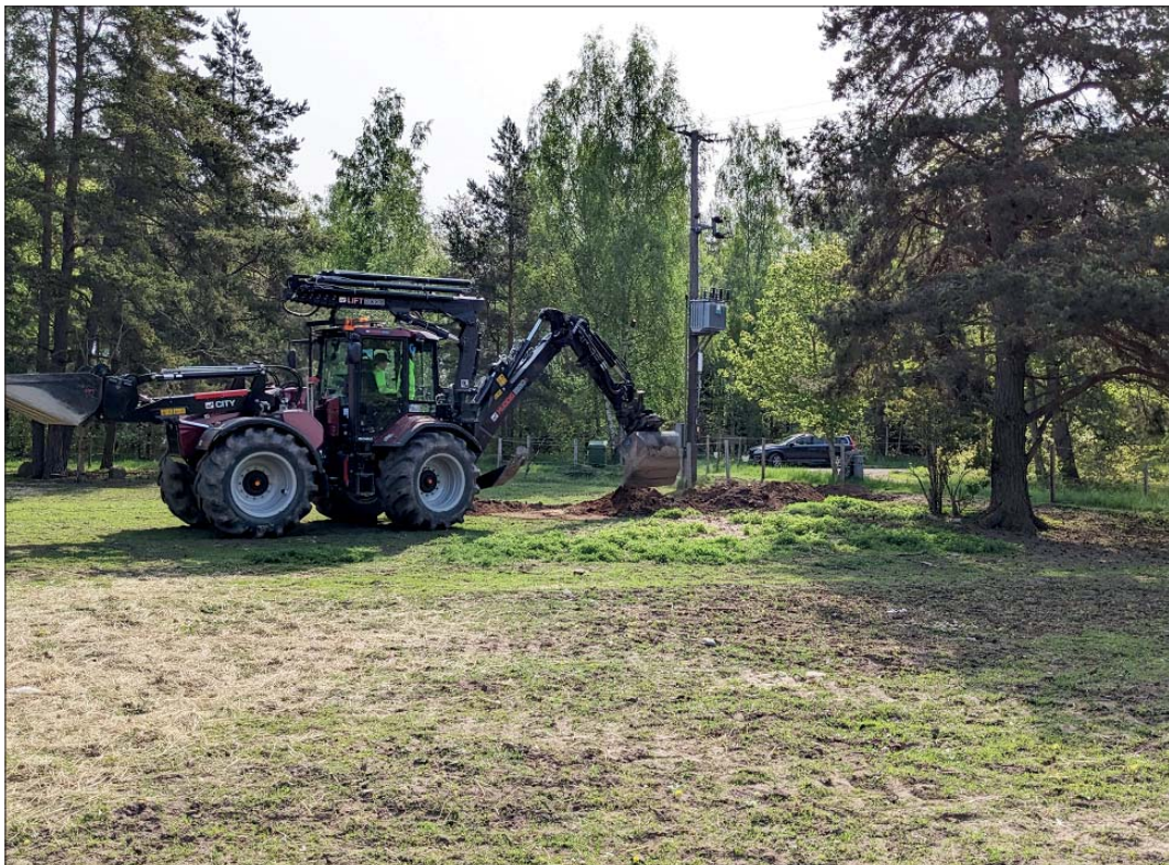
Figur 9. Undersökningsområdet vid Kårarp. Schakt S214 igen, nu sett mot sydöst. Foto Roger Lundgren, ÖM.
