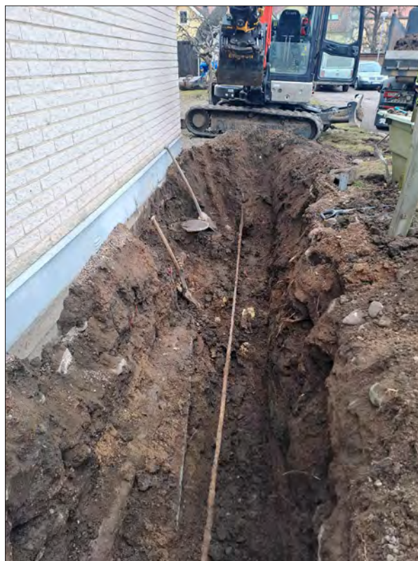
Figur 10. Schaktet närmast husväggen till befintligt bostadshus var genombrutet av flera ledningar, bla för VA.
