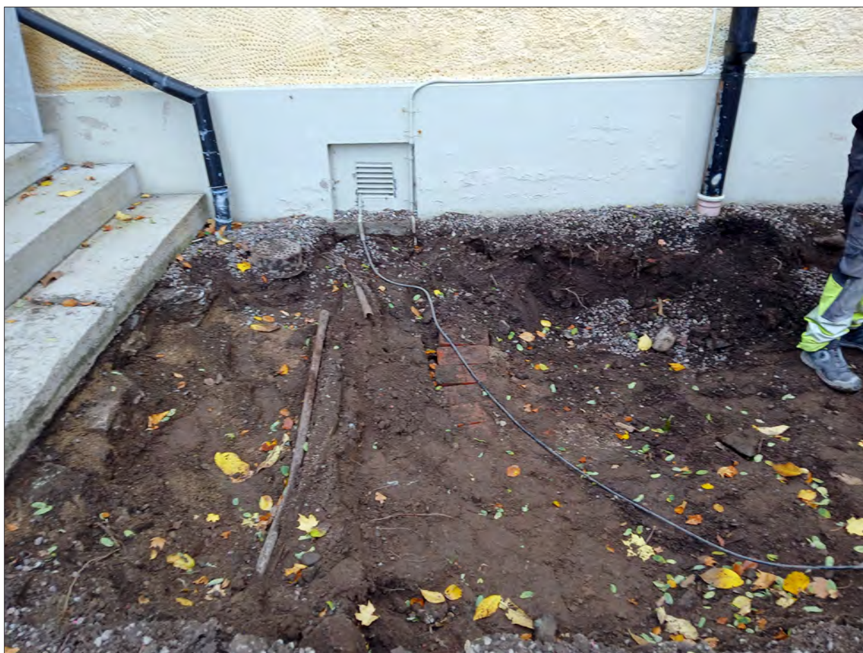
Figur 4. Diverse kablar i schaktets östra del, närmast entrétrappan. Foto från norr, Ann-Charlott Feldt, ÖM.
